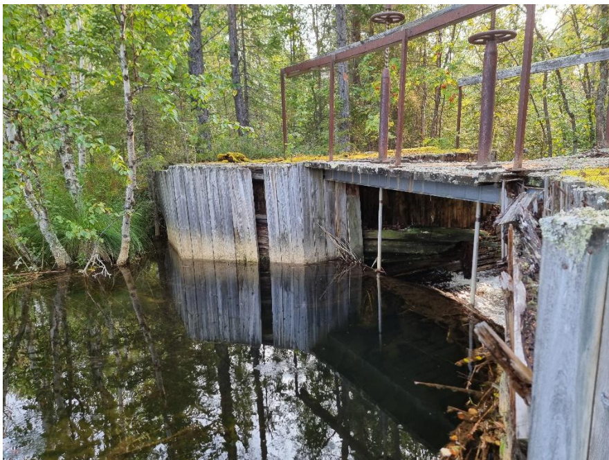
Foto 7. Utskov befintlig damm. Trä, betong samt metallskrot utrivs.
